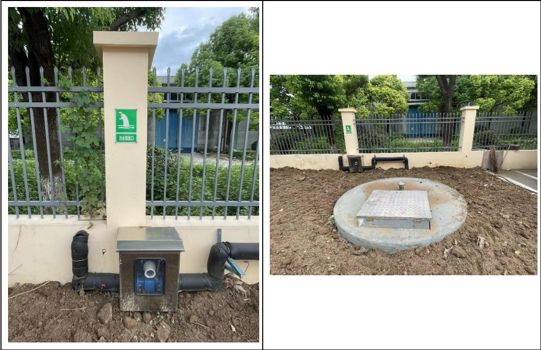
图 3-1 生活污水预处理设施及排放口现状图
