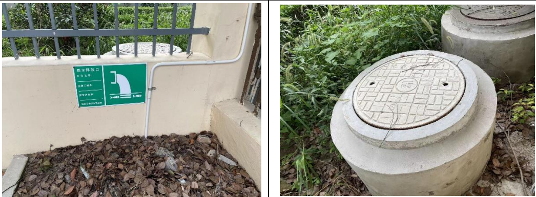
图 3-2 雨水排放口现状图
