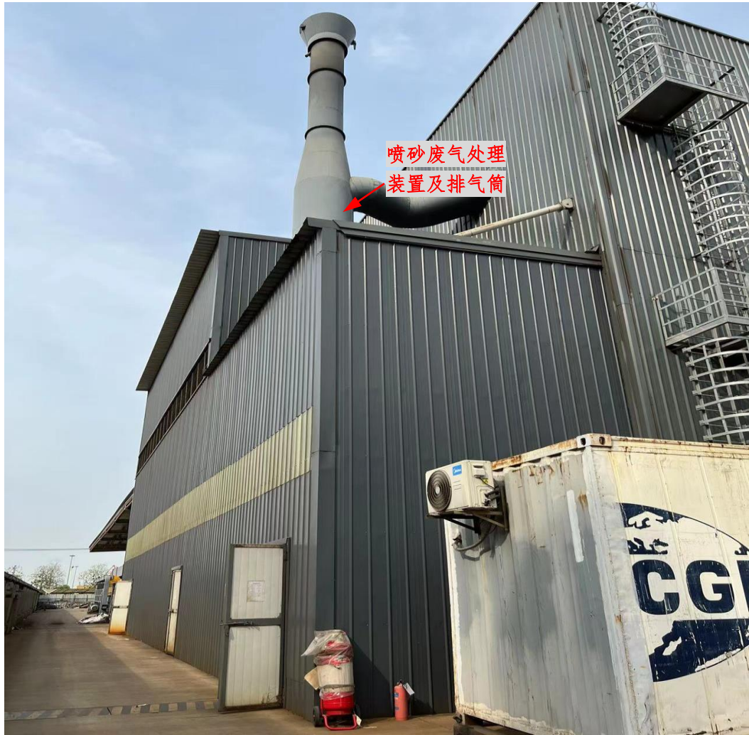
图 4-3 废气处理设施
