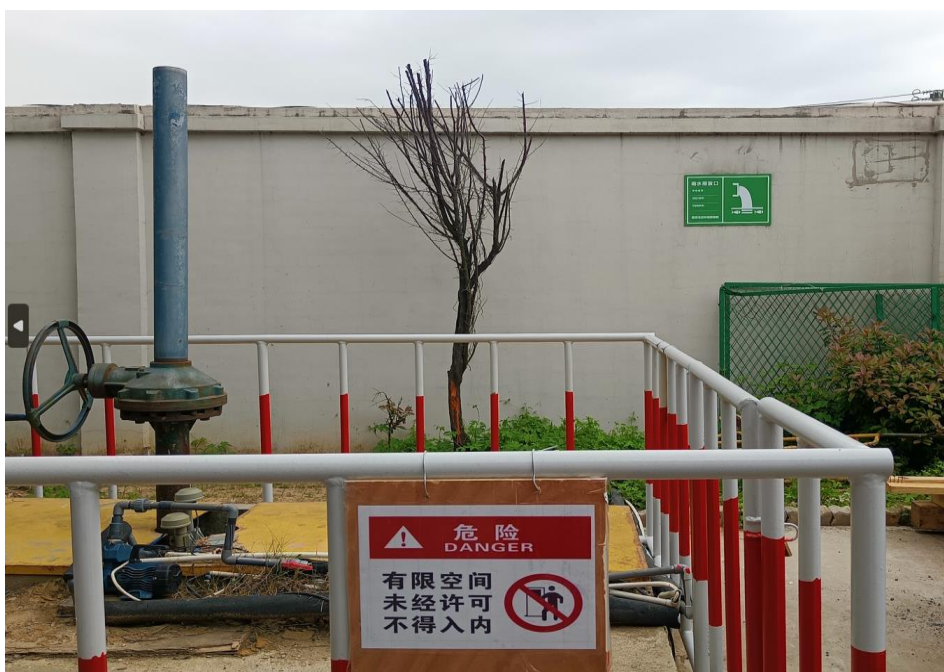
图 4-2 雨水排放口现场照片
